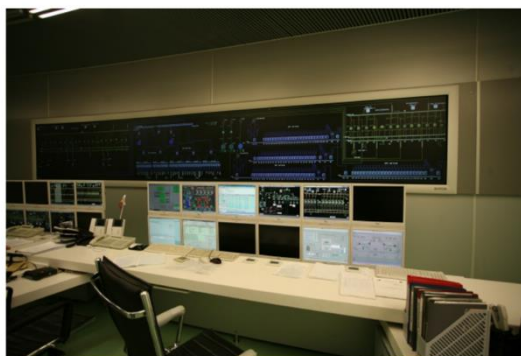
Рис. 2. Щит управления на ТЭЦ-27, 2012 год, г. Москва [13]
