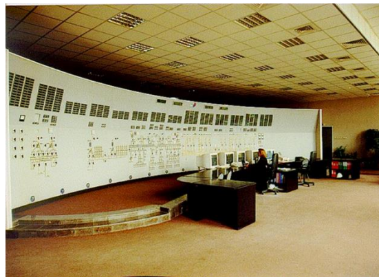
Рис. 1. Щит управления на ТЭЦ-27, 90-е годы 20-го века, г. Москва [12]
